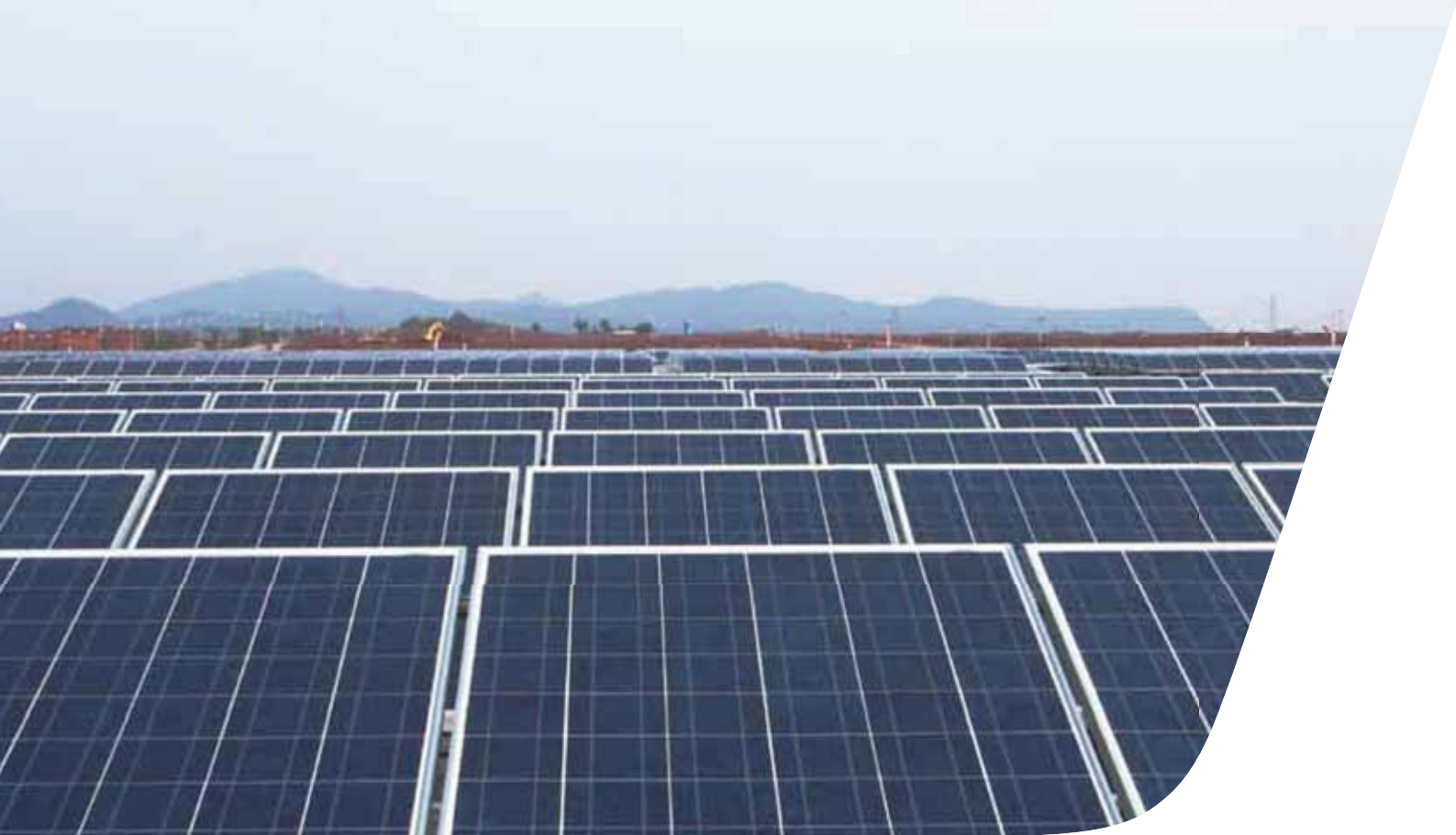
Foto cedida por: LDK Solar Power Tech./ Ubicación: Xin Yu, China/ Tamaño del sistema: 2MW/ LDK aplicación sobre cubierta en fábrica
